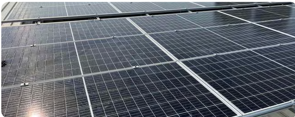
新竹基地太陽能發電設備
