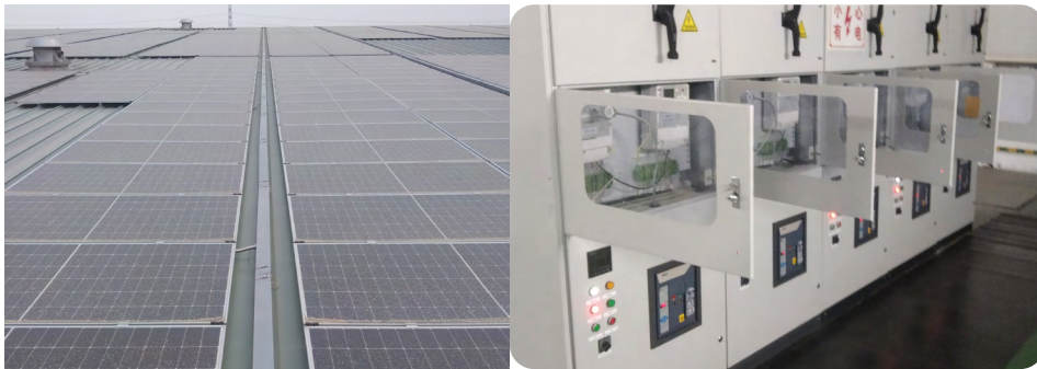
河南基地太陽能發電設備
