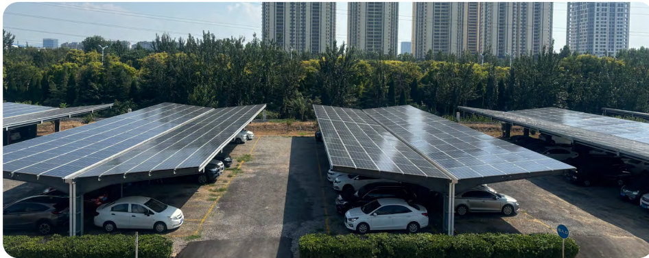
山東基地太陽能發電設備
