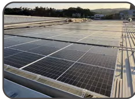
新竹廠太陽能發電設備
